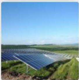
Jichisu de Jos, Cluj, RO 6,4 MW
